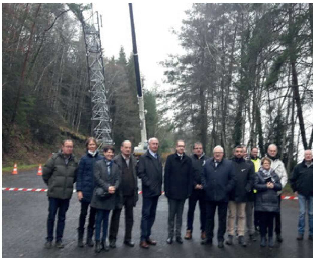
montage du pylône de Soursac 12 décembre 2019 en présence de monsieur Fabien Sésé, sous-préfet d'Ussel, référent départemental ruralité
