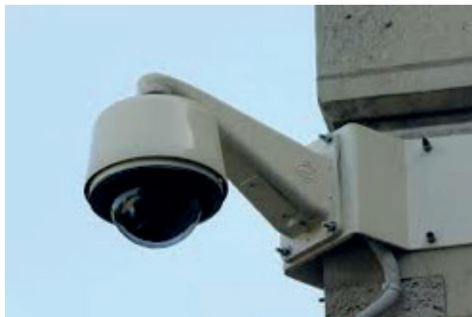
exemple de caméra de vidéoprotection financée par le FIPD à Brive
